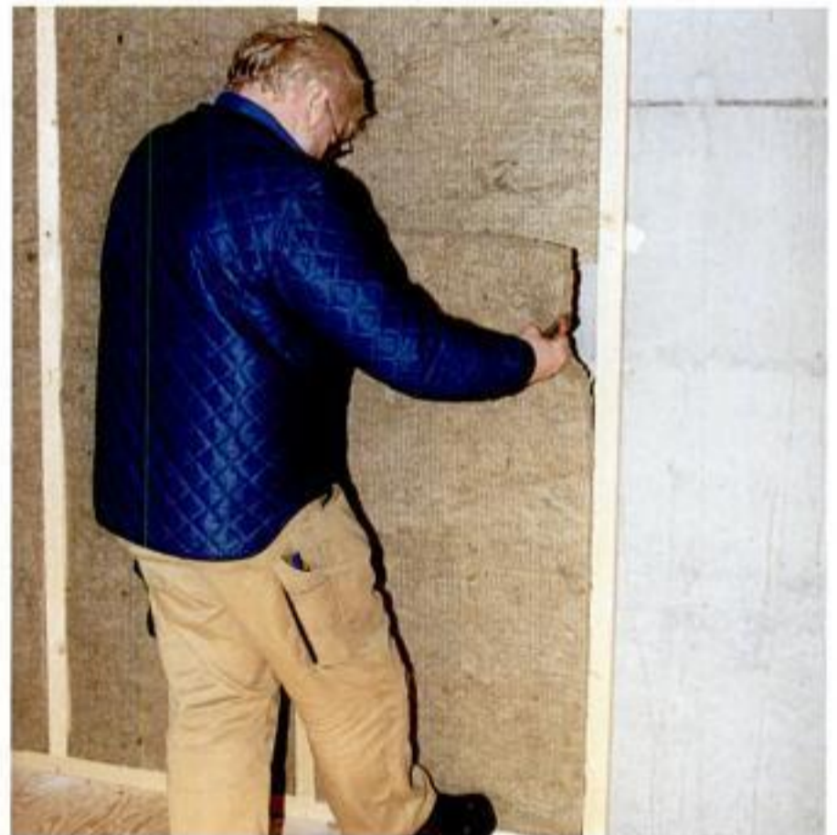
Bjálvað verður við steinull. Veggurin er betongveggur ímillum samanbygd hús. Tí verður einki tjørupapp brúkt.
