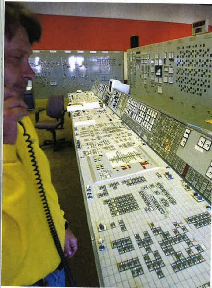
Ved hjælp af de mange instrumenter på væggene i dette kontrolrum kan man holde øje med, om alt fungerer tilfredstillende.
